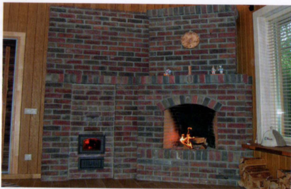
Поддувальная дверка банной печи плотно закрыта. Так печь высасывает воздух из парной
